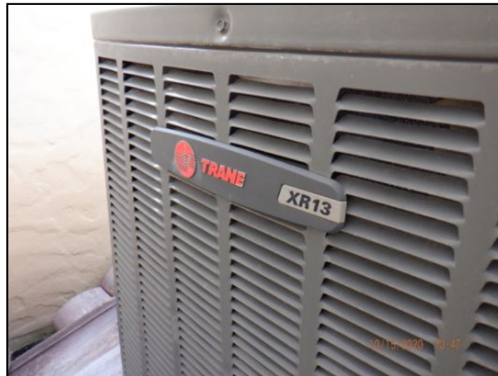
West Trane 2007 3 ton R410A
