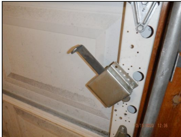
Left door broken lock
